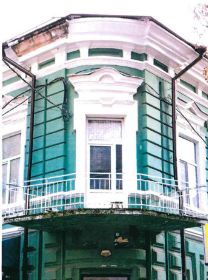
4. Балкон угловой северо-западной раскреповки. Фото 12.2023 г.
