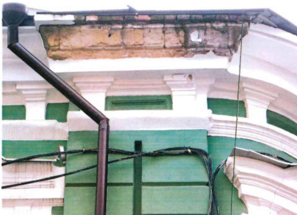
10. Обрушение штукатурного слоя наружной отделки венчающего карниза северного фасада Объекта. Фото 12.2023 г.
