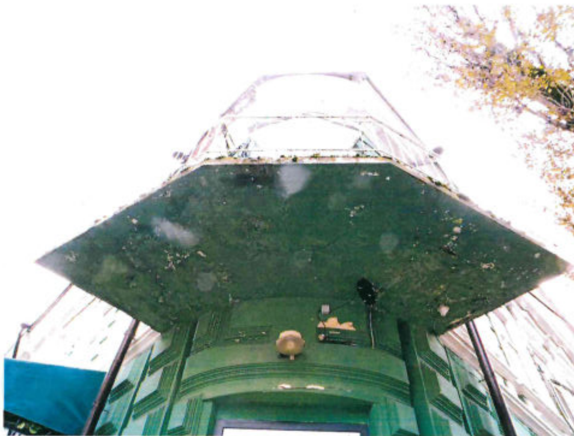
9. Железобетонная плита балкона угловой раскреповки. Фото 12.2023 г.
